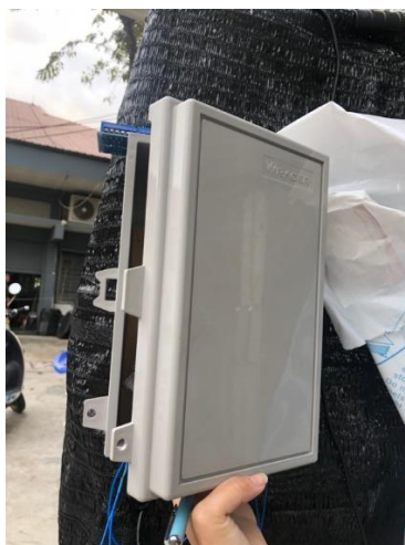
ภาพที่ 3-16 ตำแหน่งของการติดตั้งตู้คอนโทรล
