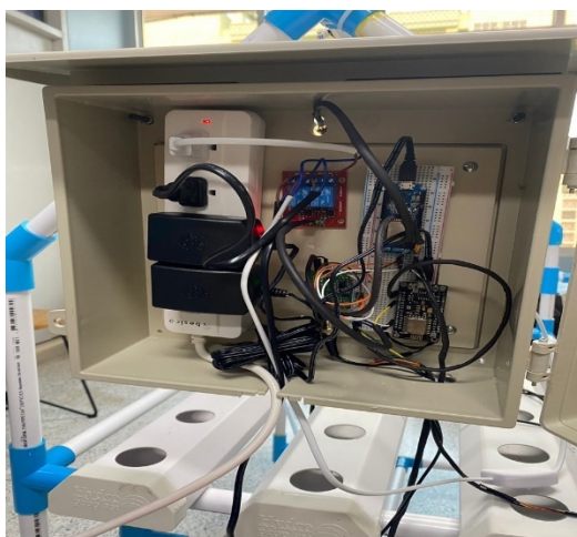
รูปที่ 4.1 ติดตั้งอุปกรณ์ของระบบ ความคุมน้ำ ควบคุมเปิด-ปิดไฟ ควบคุมที่พ่นน้ำ ควบคุมเซนเซอร์วัดค่าPH เซนเซอร์ความเข้มข้นแสง เซนเซอร์วัดอุณหภูมิของน้ำ
